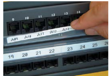
Labels voor aansluitklemmen en patchpanelen
